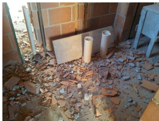
Figura 22 – Resíduos de blocos cerâmicos oriundos da quebra para a instalação de tubulações embutidas
