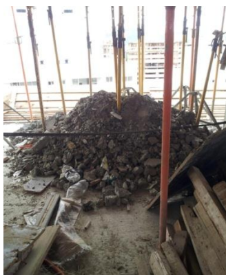
Figura 8 – Resíduo de concreto
