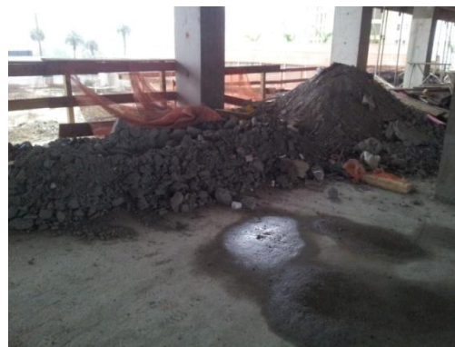
Figura 18 – Formação de acúmulo de calça no pavimento
