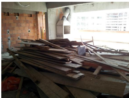
Figura 17 – Formação de acúmulo de resíduos de madeira no pavimento
