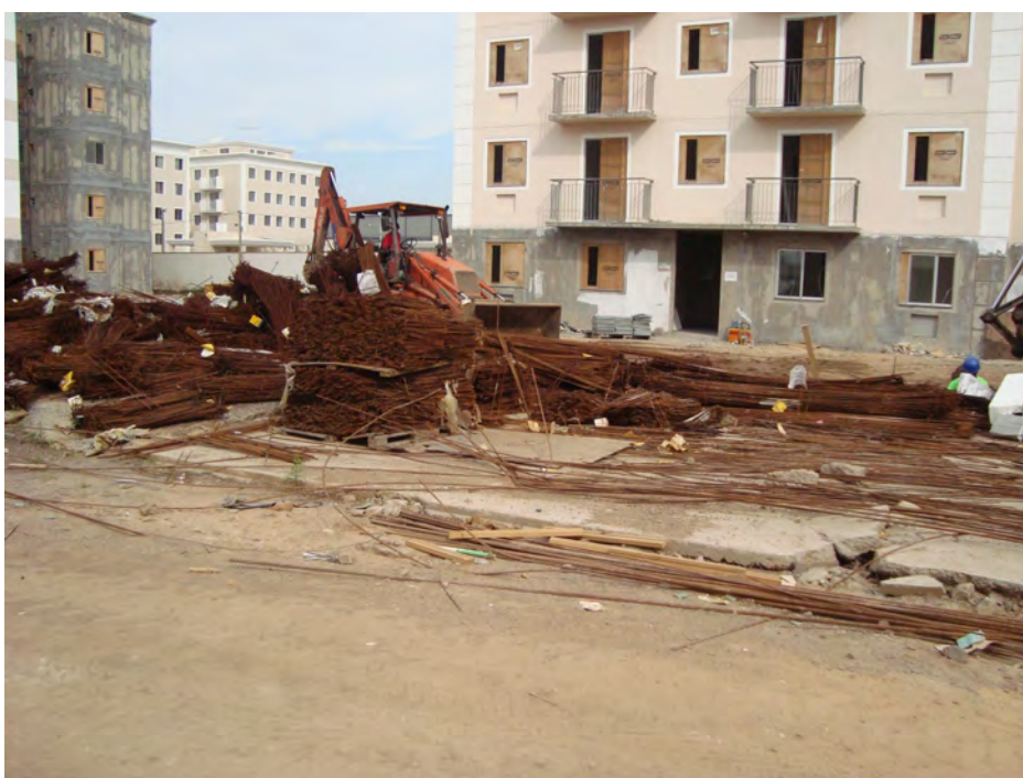
Figura 30 – Armaduras estocadas diretamente no solo
