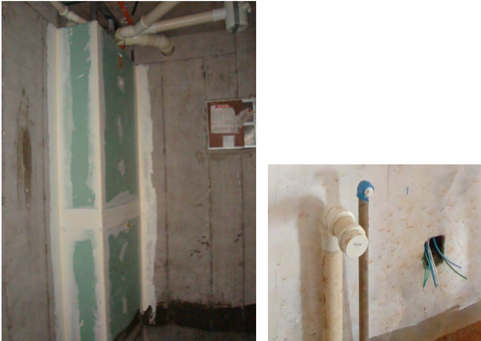
Figura 27 – Shafts e tubulações hidráulicas
