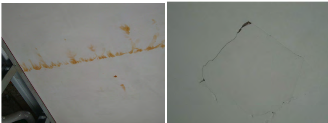
Figura 42 – Corrosão de armadura provocada pelo contato do revestimento de gesso e descolamento do revestimento de gesso pela infiltração de umidade
