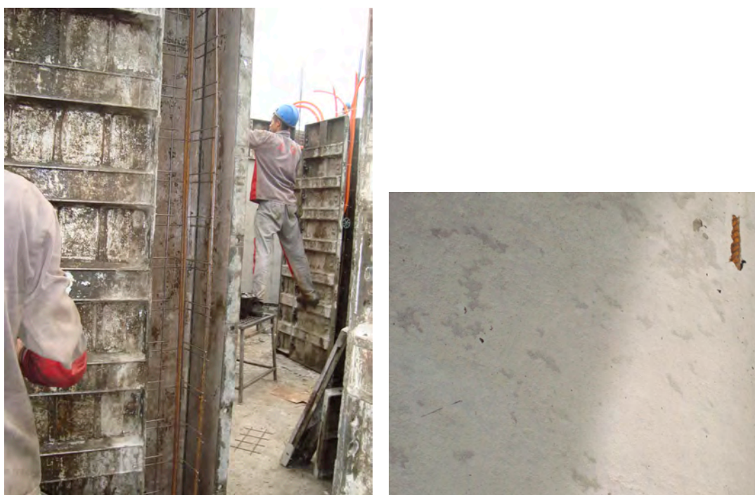
Figura 32 – Armadura sem espaçador e exposta após desforma
