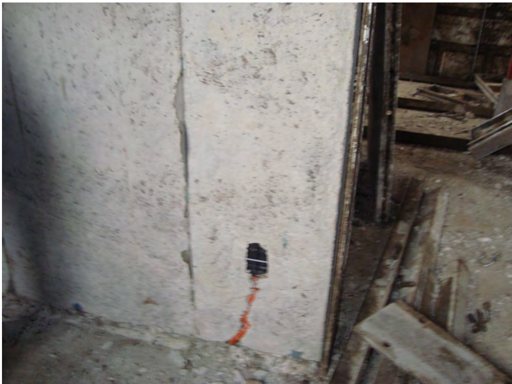
Figura 28 – Tubulação elétrica aparente
