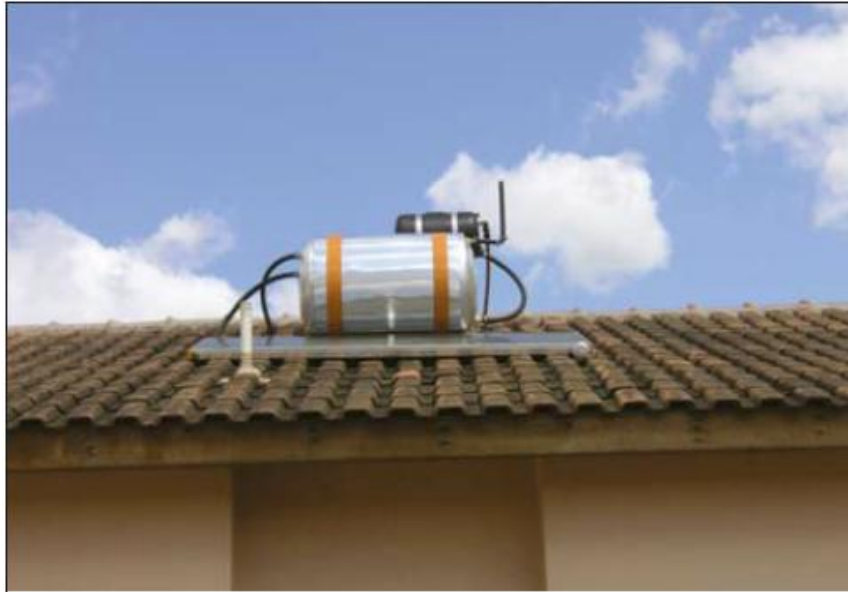
Figura 10 – Coletor apoiado de forma simples sobre o telhado
