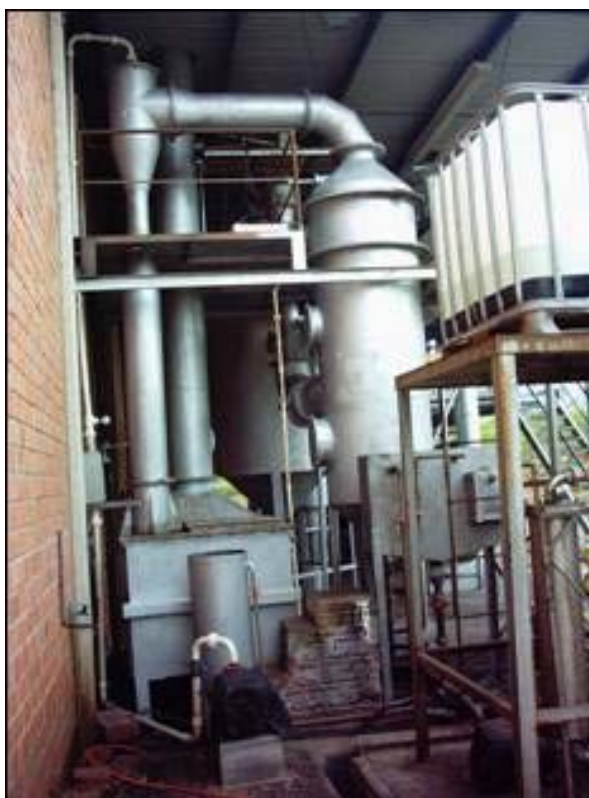
Vista do lavador venturi (9)
