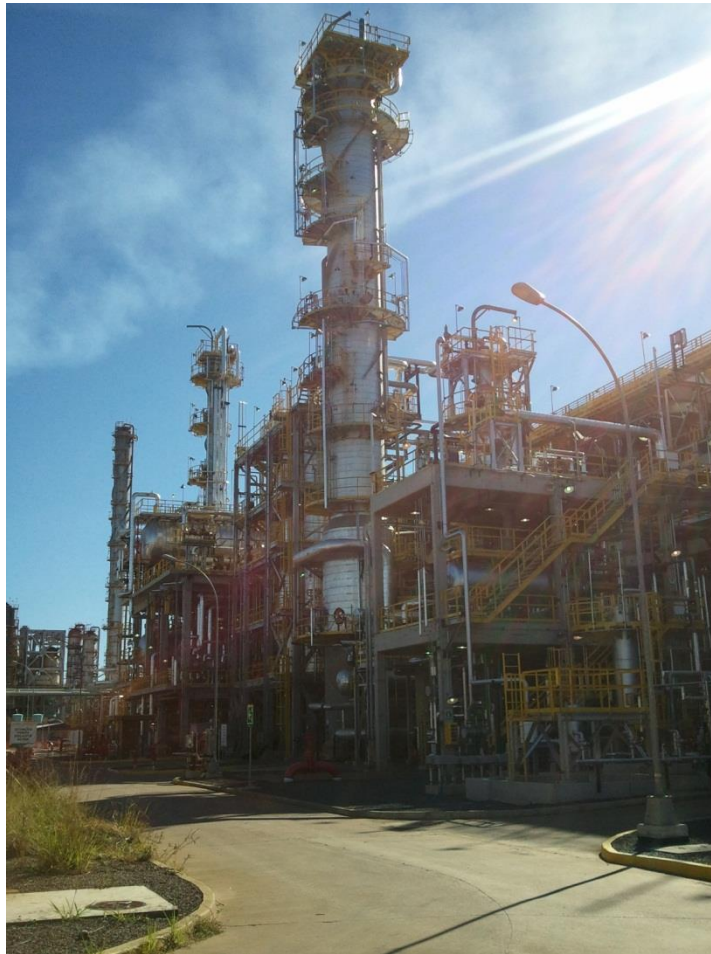
Figura 3.2: Torre Fracionadora do HDS- REFAP/PETROBRAS.
