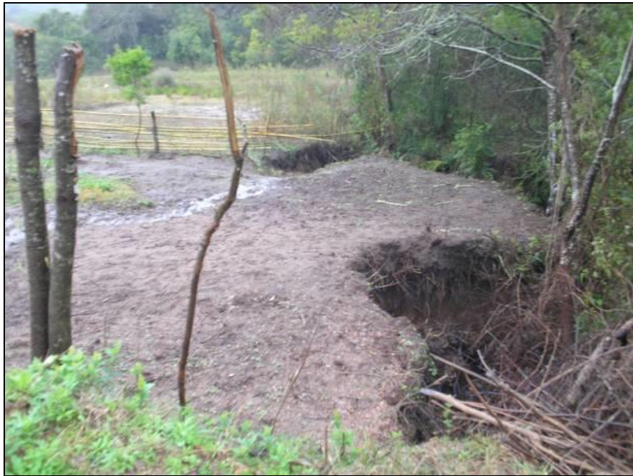
FIGURA 8: Erosão às margens do córrego s/n
