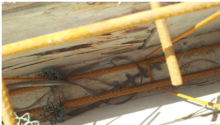
Figura 35 – Falta de limpeza no fundo de viga
