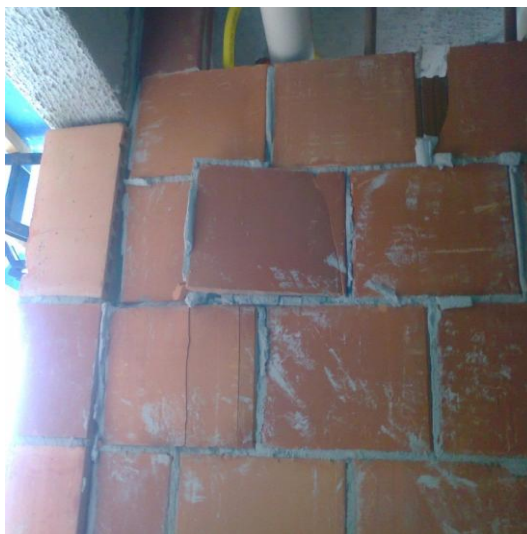
Figura 21 – face do bloco se destacando da parede
