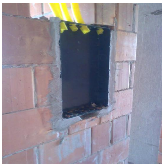
Figura 11 – quadros gerais das instalações elétricas não adaptados à modulação
