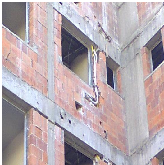
Figura 19 – corte na fachada do edifício
