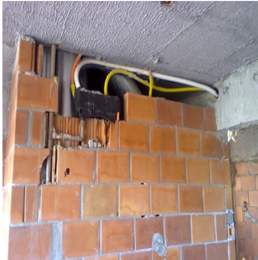
Figura 17 – espera do ar-condicionado tipo split sem a vedação completa
