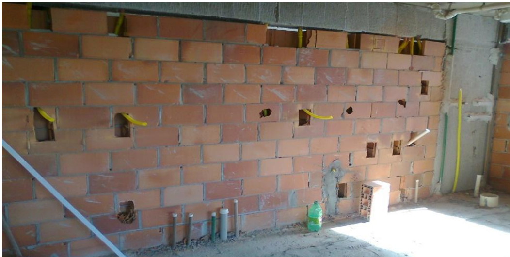
Figura 9 – erro de projeto de alvenaria de vedação para inserção de caixas para instalações elétricas
