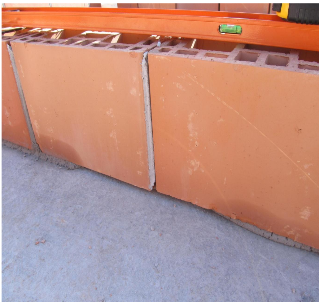
Figura 8 – Falha no assentamento da primeira fiada
