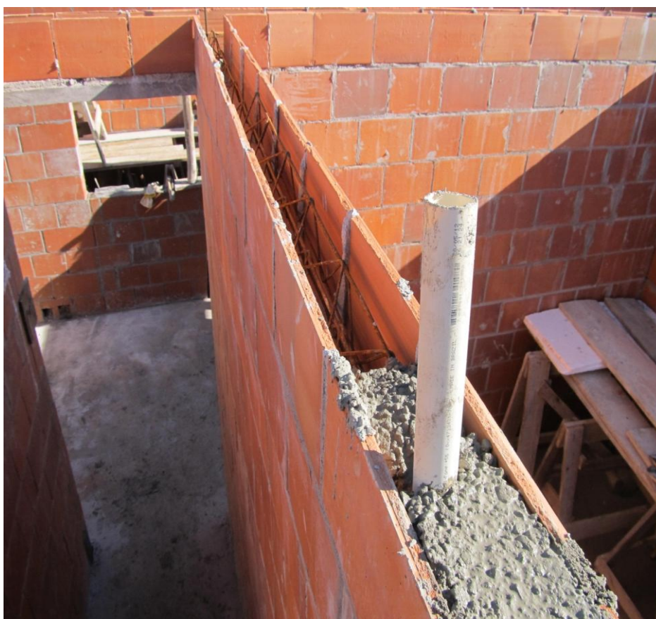
Figura 12 – Falha no umedecimento das treliças e blocos canaletas
