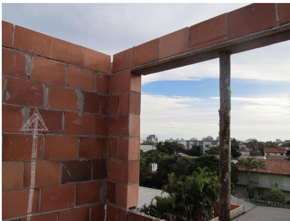
Figura 13 – Falta do uso correto de gabarito
