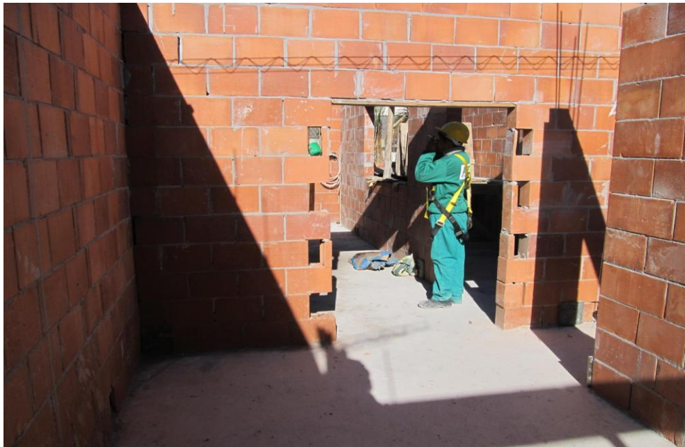
Figura 10 – Construção incorreta de amarrações de contrafiadas
