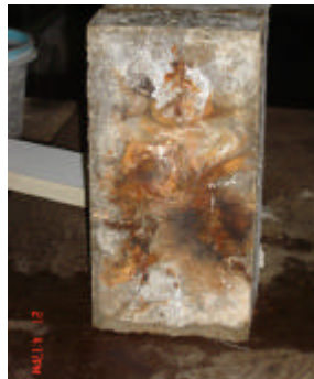
Figura 3 - Efeito da corrosão na superfície do concreto.
