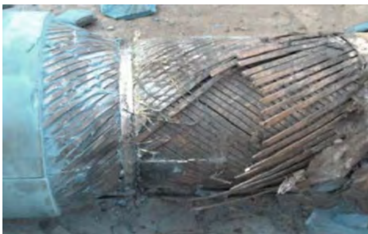
Figura 1. Detalhe da ruptura de tendões próximos à interface com o conector. (1)
