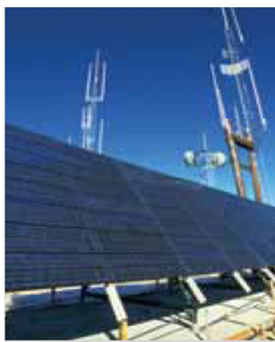
Figura 33: Atendimento a estação de telecomunicações.
