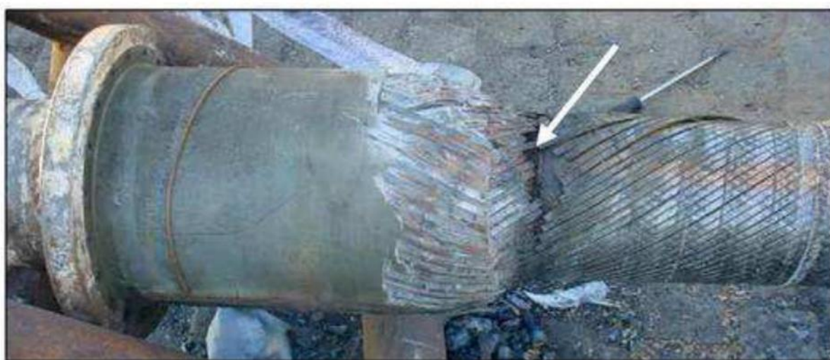
Figura 1.1 Detalhe da ruptura de tendões próximos à interface com o conector (BUENO 2010).
