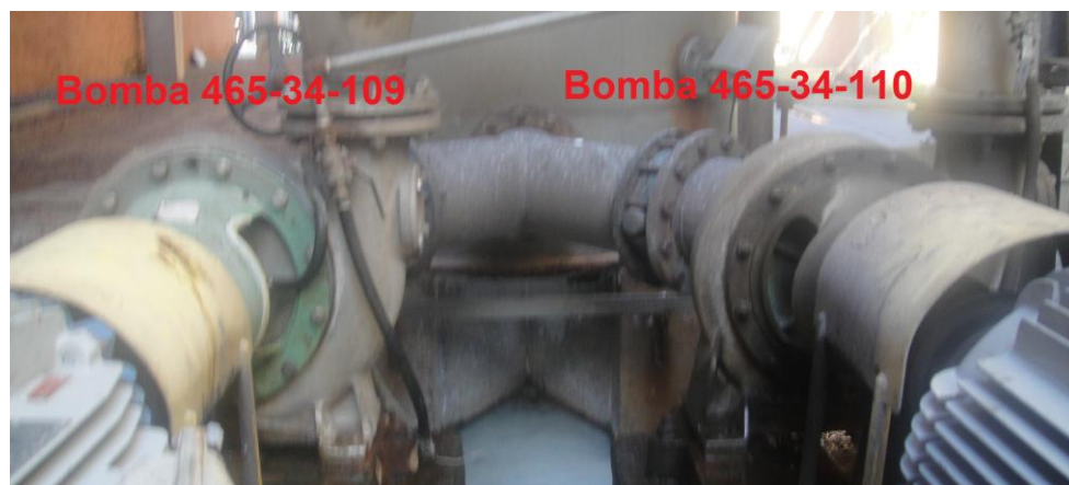
Figura 4.1.4 - Bombas, 465-34-109 na esquerda e 465-34-110 na direita.
