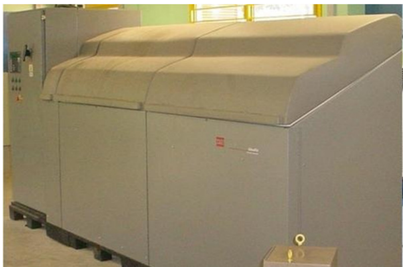
Figura 3.2 - Unidade hidráulica para 206 bar de pressão.
