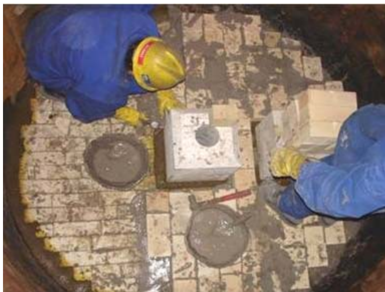
Figura 3.3 – Montagem dos Refratários Permanentes Fundo da Panela e Sedes Fonte Gerdau Riograndense, 2009.
