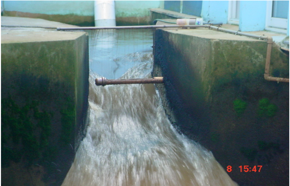
Figura 4.3. Entrada da água bruta com o ponto de coleta ao fundo e, em primeiro plano, a dosagem do coagulante.
