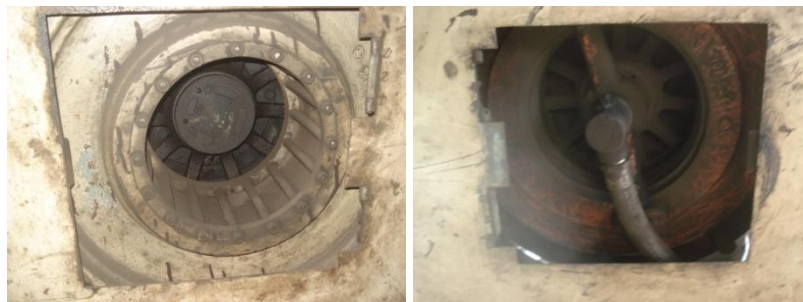
Fig. 7 e 8 – Proteções laterais avariadas nas áreas das polias de acionamento. (Fonte empresa “X”)
