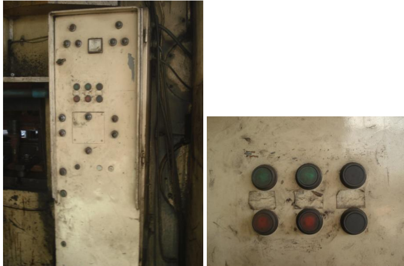
Fig. 15 e 16 – Painéis de comando sem identificação. (Fonte empresa “X”)
