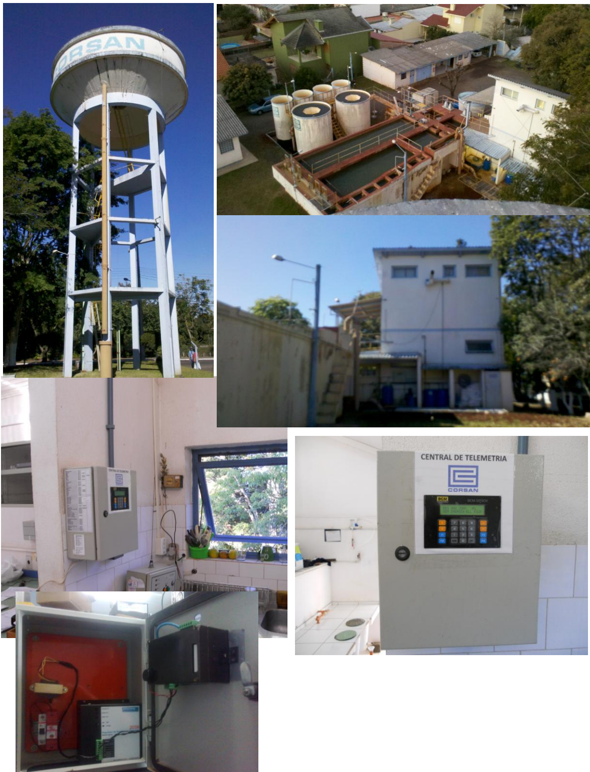
Fotos da Estação de Tratamento de Água de Dois Irmãos (Central de Telemetria Instalada)
