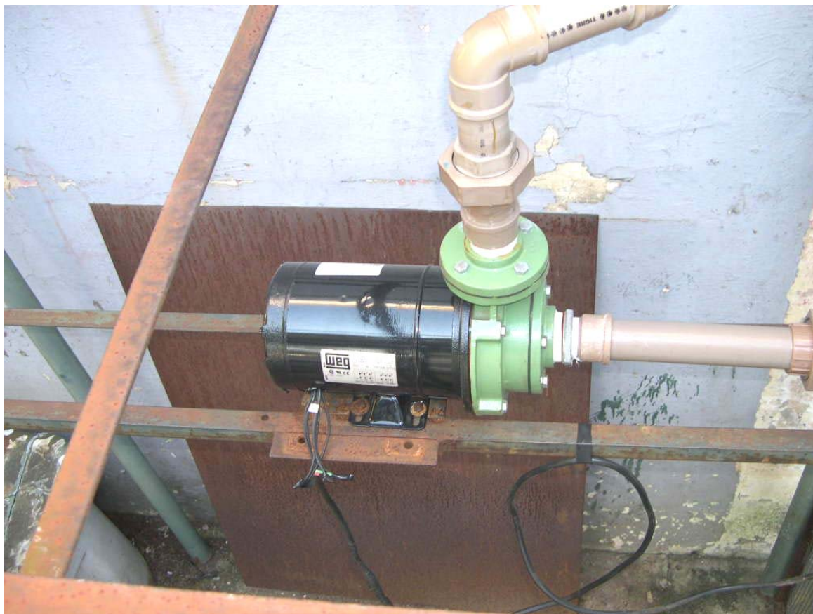
Figura 6.2 – Motobomba Centrífuga Schneider BC-92SJC instalada.
