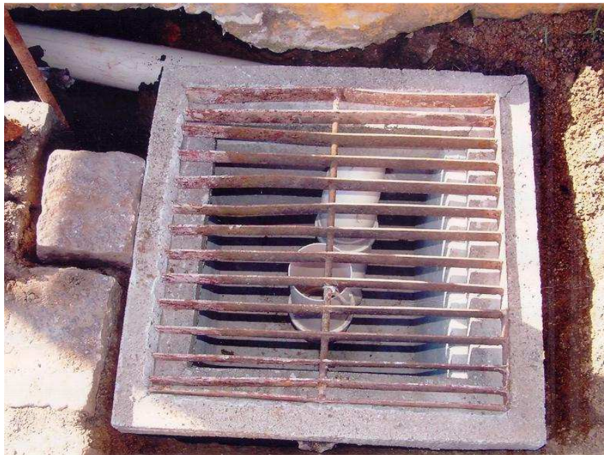
Figura 8 – Caixa ecológica para esgotos instalada em Viamão/RS
