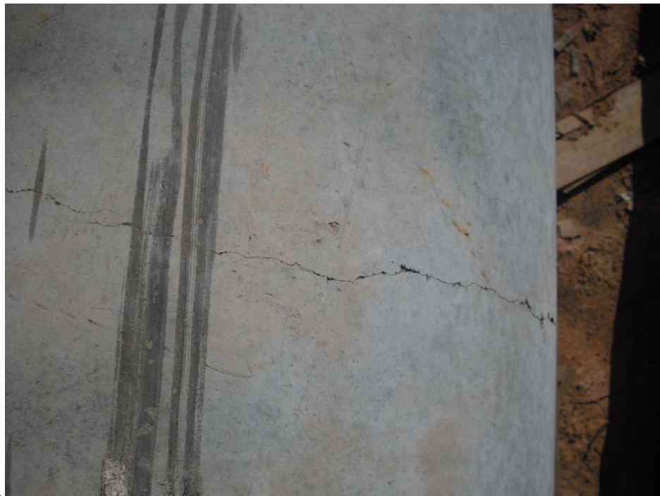
Figura 19 – Trinca ocorrida no processo de cravação da estaca
