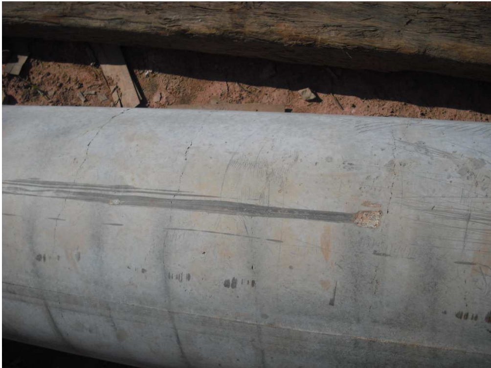
Figura 18 – Danos ocorridos no corpo da estaca
