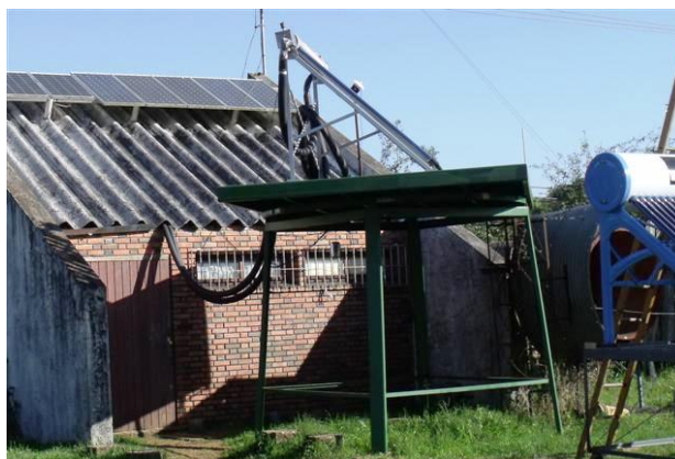
Figura 4.8 - Coletor solar de tubos evacuados montado na bancada.
