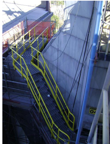
Figura 9 – Passarela frontal do Filtro de mangas
