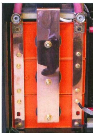
Figura 2.35 - Barras de cobre para conexão dos capacitores [Martel e Bultman, 2007].
