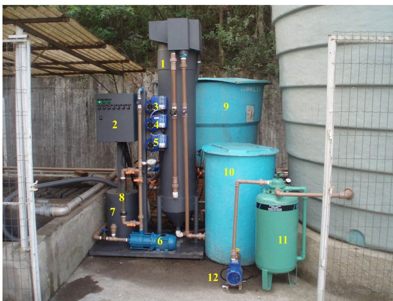
Figura 20. Estação de tratamento de efluentes em nível piloto instalada no PML (tanque agitado e processo FFC-A): 1- Coluna de flotação; 2 - Quadro elétrico; 3 a 5 - Bombas peristálticas; 6 - Bomba centrífuga multifase; 7 - RGF ® ; 8 - Rotâmetro; 9 - Tanque agitado; 10 - Reservatório intermediário; 11 - Filtro de areia; 12 - Bomba do filtro de areia
