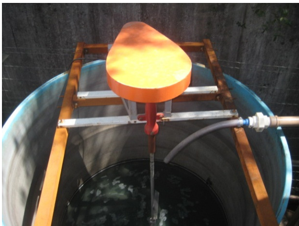
Figura 21. Tanque agitado, para equalização e coagulação do efluente.
