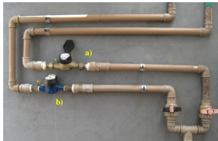
Figura 17. Hidrômetros instalados no LRC: a) água de makeup (abastecimento público) e b) água de reúso (Processos FFC-A ou FFC-AC).
