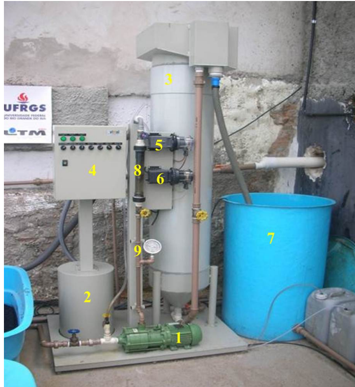
Figura 14. Equipamento FFC-A instalado no LRC: 1 - Bomba centrífuga multifase; 2 - RGF ® ; 3 - Coluna de flotação; 4 - Painel elétrico; 5 - Bomba peristáltica (dosagem de PBT); 6 - Bomba peristáltica (dosagem de hipoclorito de sódio); 7 - Reservatório intermediário; 8 - Rotâmetro; 9 - Manômetro.
