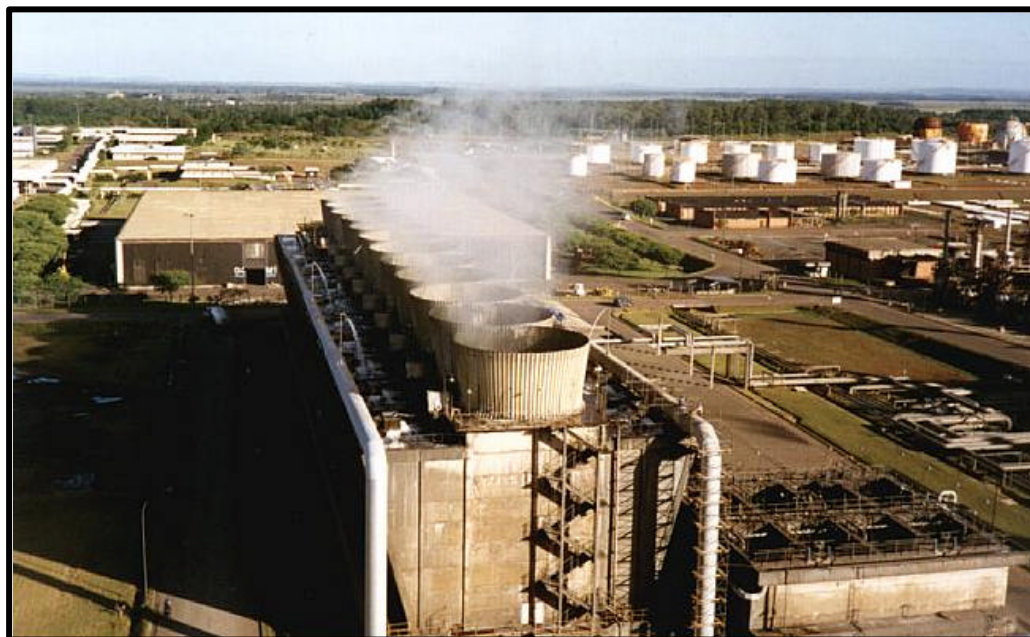
Figura 3.4. Torre de resfriamento de tiragem induzida da indústria.
