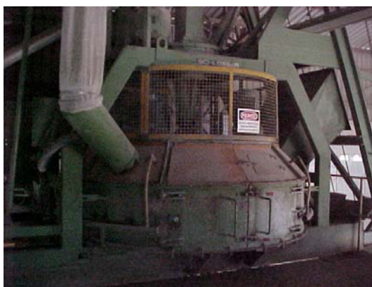
Figura 15 - Misturador automatizado – recebimento de cimento, água e aditivos Fonte: Obtido junto a empresa
