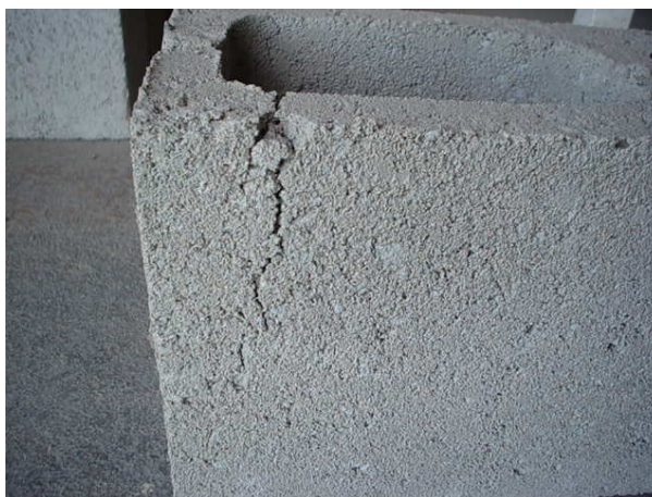
Figura 63: Trincas Fonte: Obtido junto a empresa
