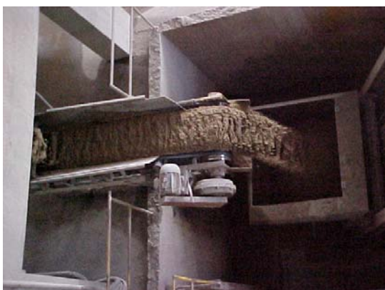
Figura 14: Alimantação por gravidade dos agregados, para o transportador vertical Fonte: Obtido junto a empresa]
