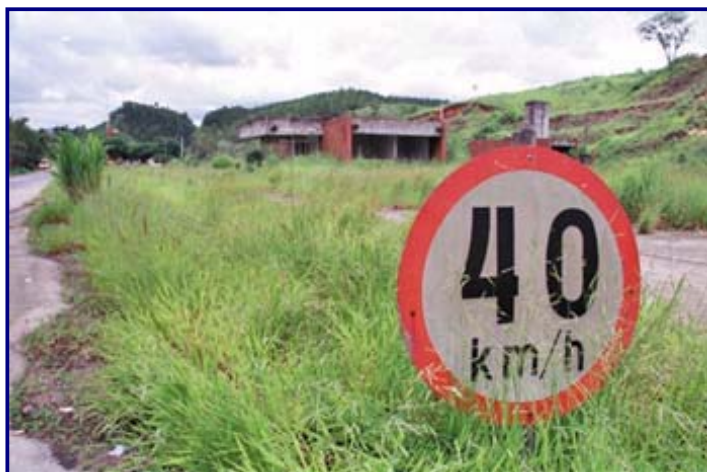
Figura 5 – Lixo e destruição formam o cenário de um posto de pesagem desativado
