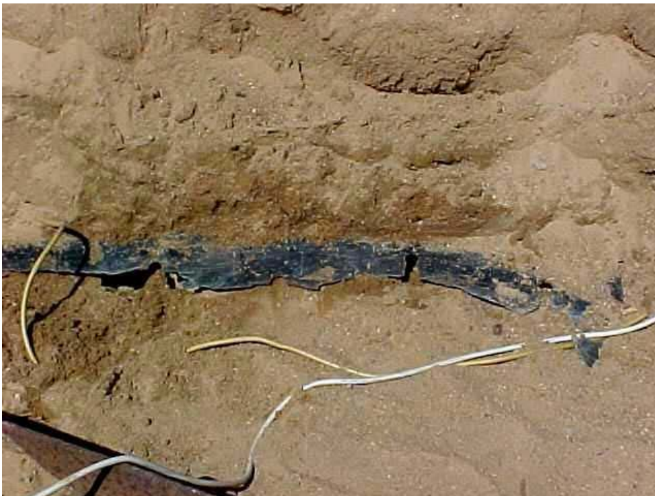
Figura 5.4 – Ruptura do geotêxtil resinado na segunda tentativa de carregamento do geotêxtil inferior.
