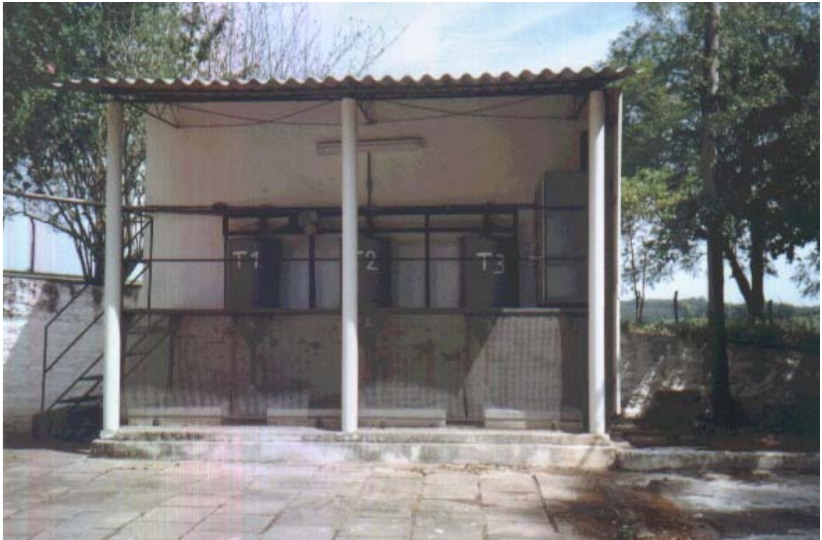
Figura 7: Estação de tratamento de efluentes da Fundação Escola Técnica Liberato Salzano Vieira da Cunha
