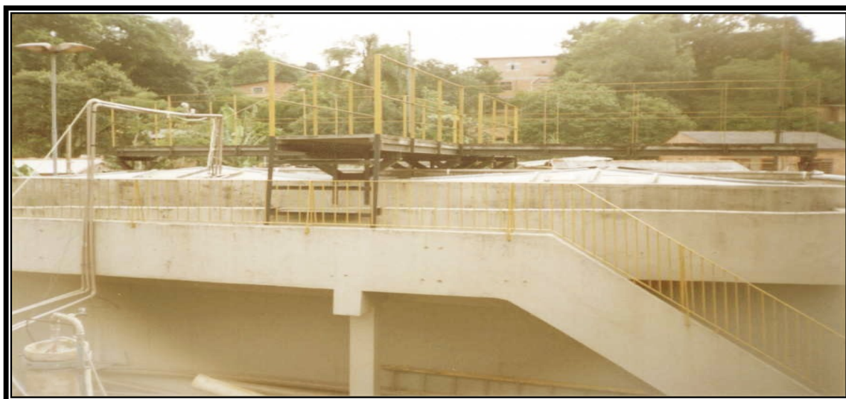
FIGURA 5: Estação de Tratamento de Esgoto Esmeralda – Sistema de Reator Anaeróbio de Fluxo Ascendente e Manta de Lodo (UASB)
