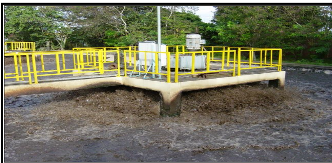
FIGURA 2: Estação de Tratamento de Esgoto Sapucaia – Sistema de Lodo Ativado
