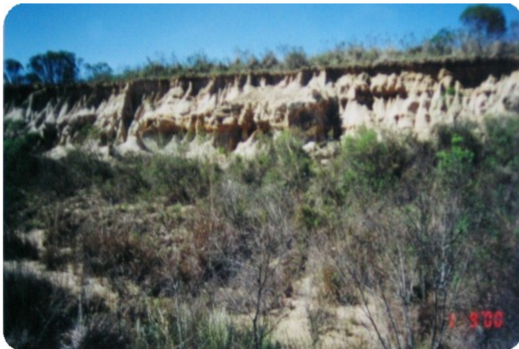
Figura A.11 – Erosão longitudinal no talude acima da banquetta no km 112 + 050.
