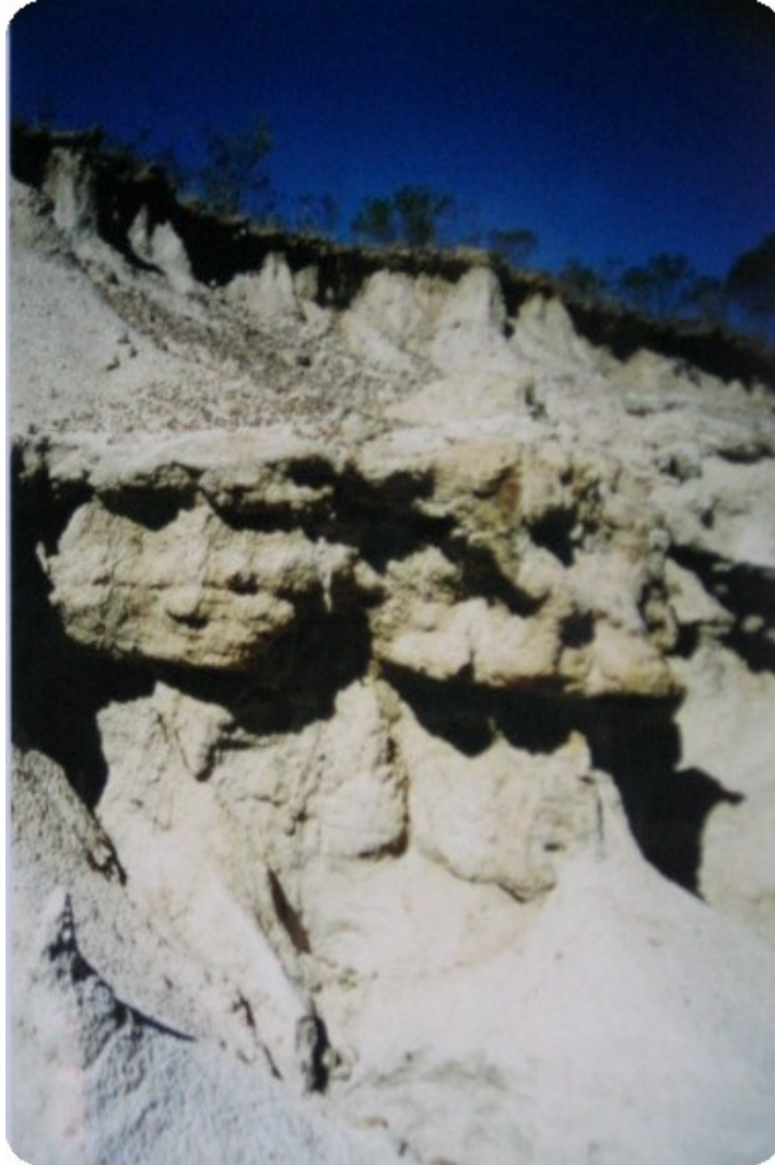
Figura A.13 – Erosão longitudinal no talude acima da banquetta no km 112 + 050.
