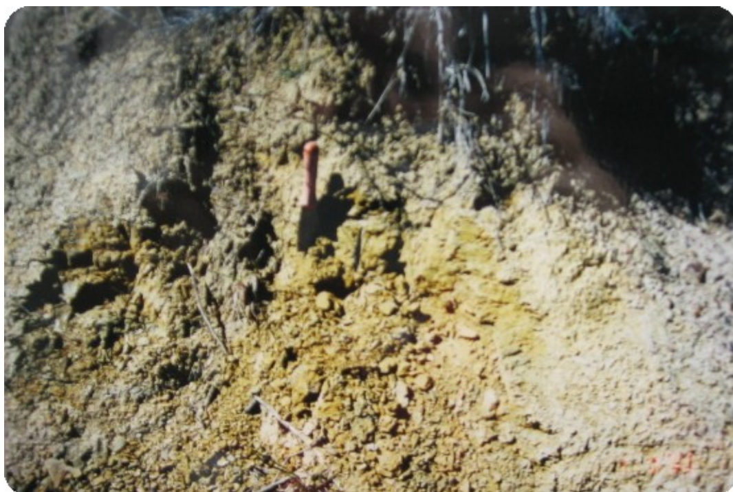
Figura A.10 – Silte cinza-amarelado que, devido á exposição às intempéries, se desagrega com facilidade.
