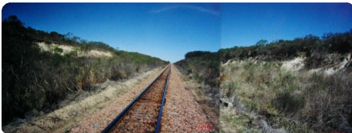
Figura A.2 – Mostra o corte em toda sua extensão a partir do km 112 + 000 apresentando a erosão longitudinal acentuada no lado esquerdo.
