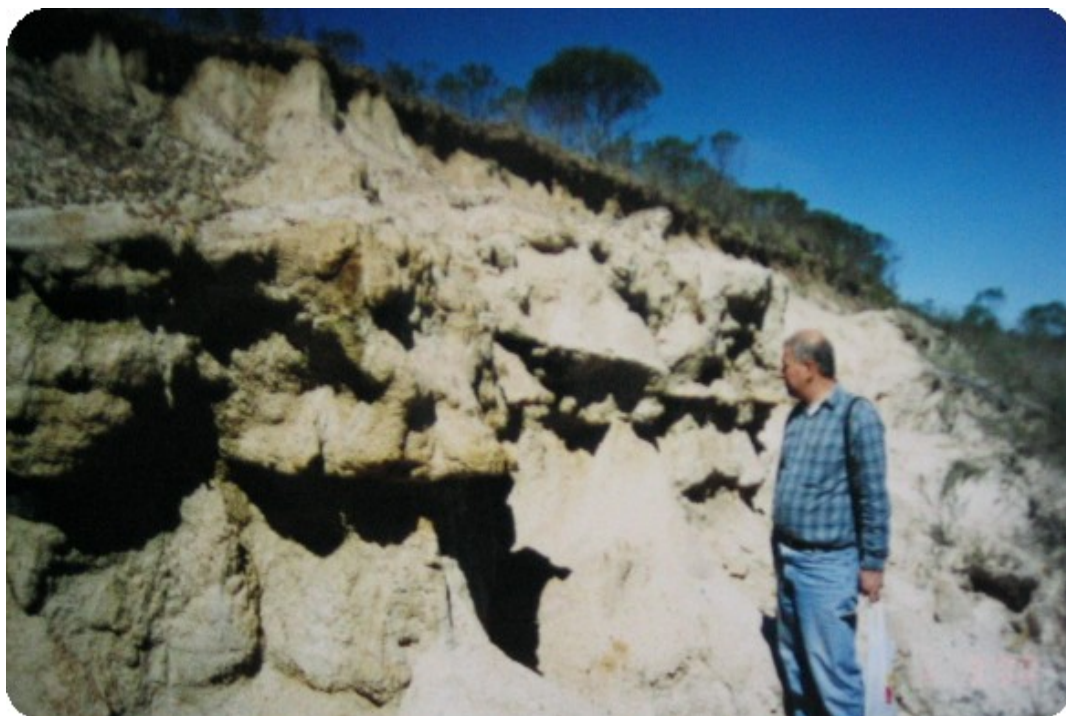
Figura A.12 – Erosão longitudinal no talude acima da banquetta no km 112 + 050.
