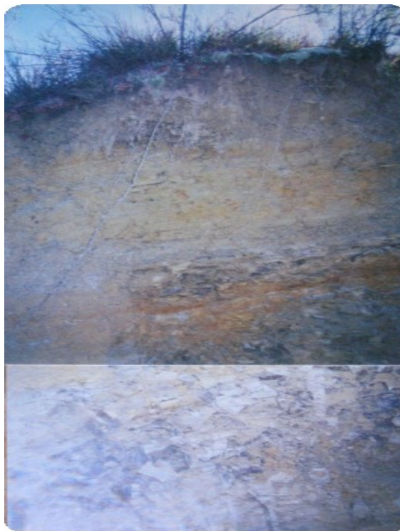
Figura 2.15: Foto LE em uma erosão provocada pela quebra do sistema de drenagem (canaleta em concreto) próximo ao furo SP-02 da sondagem (km 112 + 400)
