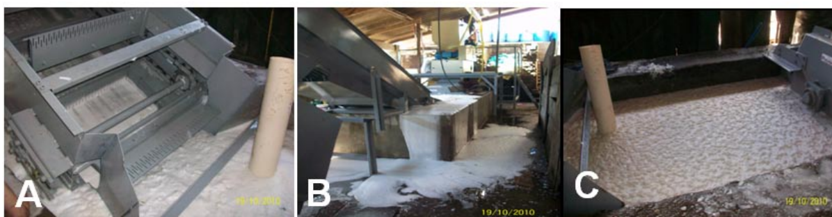
Figura 4.6 – (A) Acúmulo de espuma na entrada da esteira; (B) Vazamento de espuma e produto do tanque; (C) Tanque após o encerramento da batelada de PEAD
