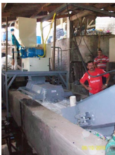
Figura 4.4 – Tanque do Processo
