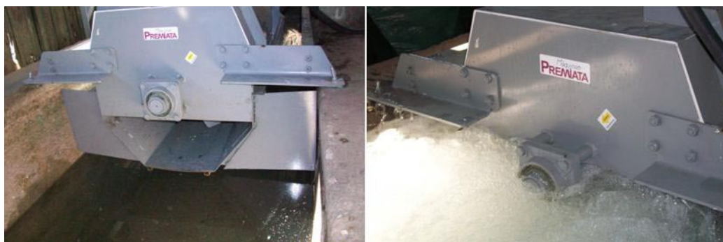
Figura 4.3 – Agitador, antes e após o tanque estar cheio.
