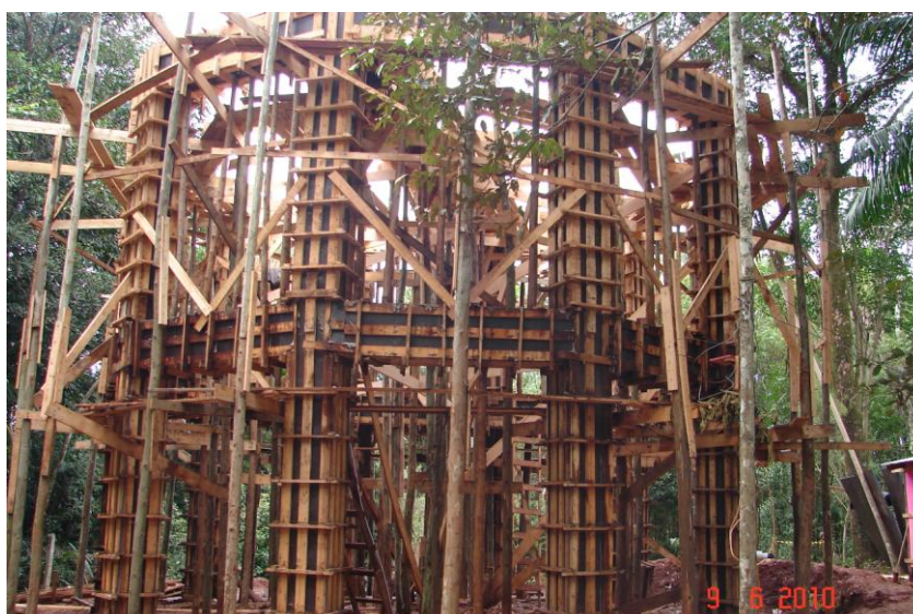
Figura 8: travamento do escoramento do reservatório
