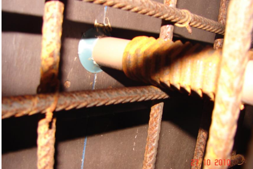
Figura 20: detalhe dos espaçadores tipo núcleo perdido e cone
