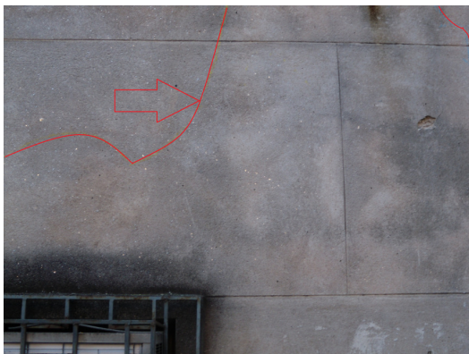
Figura 49: região do revestimento com som cavo
