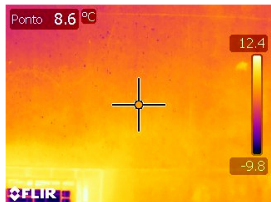
Figura 50: imagem termográfica do revestimento descolado
