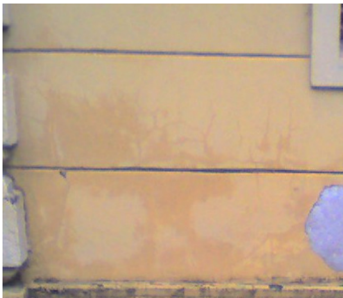
Figura 25: área da fachada Norte do Observatório Astronômico da UFRGS onde foi realizado o teste preliminar
