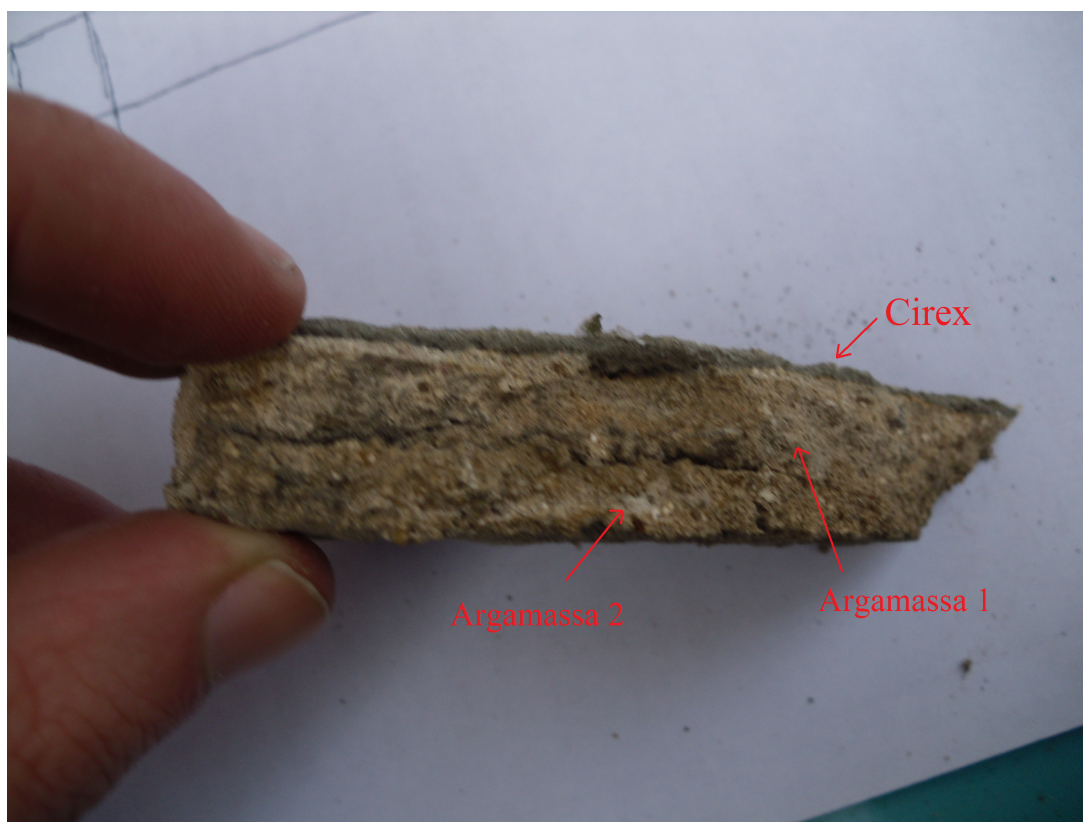
Figura 22: parte do revestimento da fachada da Escola de Engenharia da UFRGS evidenciando as diferentes camadas
