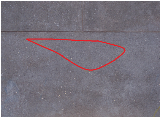
Figura 47: região do revestimento com som cavo, descolado
