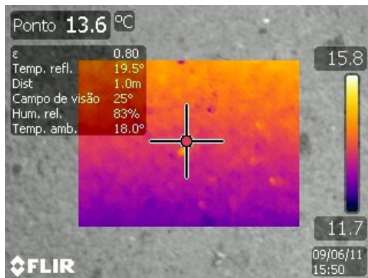
Figura 32: imagem termográfica de zona com revestimento - emissividade 0,80
