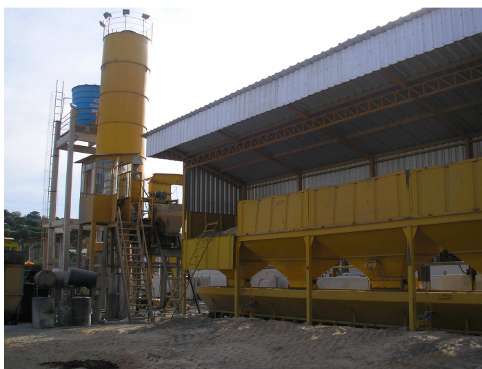
Figura 16 - Usina dosadora de concreto
