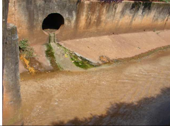
Foto 12 - Tubulação de esgoto pluvial com presença de resíduos sólidos e líquidos, talvez domésticos e industriais.
