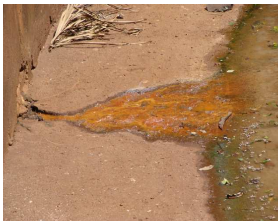
Foto 17 - Infiltração nas laterais da área canalizada do arroio com vazamento de provável chorume industrial. Há uma auto-peças e uma oficina mecânica na margem do arroio, próximas a este local.
