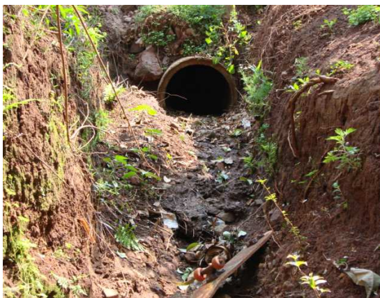
Foto 20 - Tubulação de esgoto pluvial às margens do Arroio. Presença de resíduos sólidos domésticos. Fonte: Marlise Amália Reinehr Dal Forno e Vânia Patrícia da Silva Data: 30/11/2007 Local: Arroio Pessegueirinho, Santa Rosa, RS
