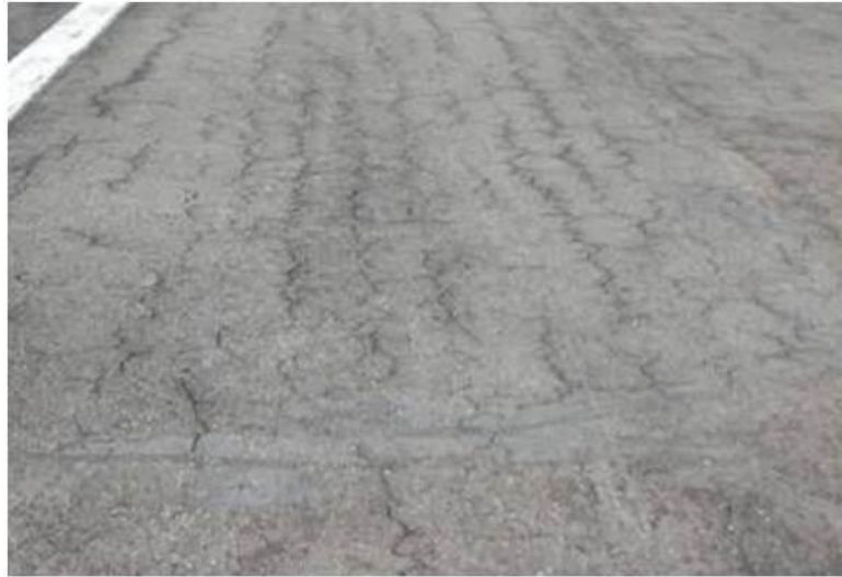
Figura 12: dano causado por fadiga em um pavimento flexível (FRANCO, 2007, p. 189)
