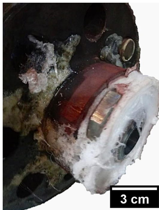
Figura 53 - Caso crítico de junta lens ring acoplada no flange de entrada com vazamento de produto (Fonte: o Autor, 2024)
