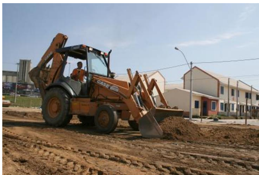
Figura 5 – Início da construção de 30 casas no Loteamento Santa Terezinha (antiga Vila dos Papeleiros), em 30 de setembro de 2007.
