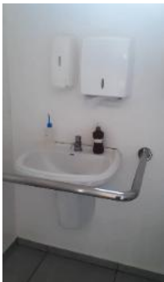
Figura 1: Lavatório da unidade do Bairro Industrial. Fonte: Autoria própria, 2023
