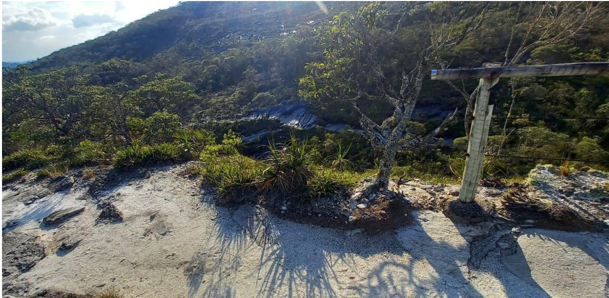
Figura 7: Descontinuidade do guarda-corpo no Paredão de Santo Antônio.
