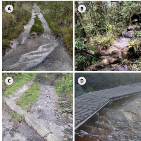
Figura 2: Ponto de alagamento (A); Ponto de raiz exposta (B); Intervenção de drenagem (C) e Intervenção de acessibilidade (D).
