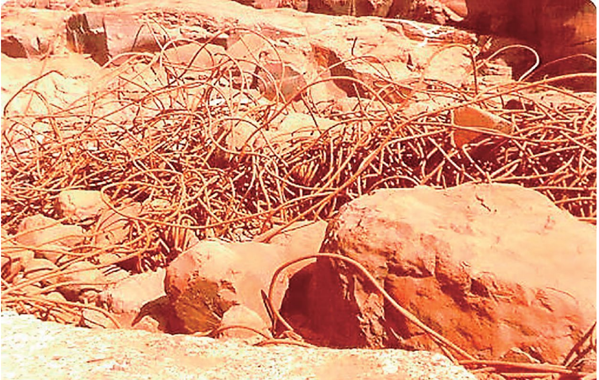
Figura 2.17 – Erosão causada na bacia de dissipação da UHE Marimbondo. Guidicini et al. (2021).
