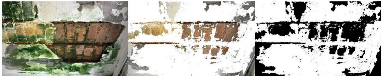
Figura 8 - Mapeamento visual de degradação
