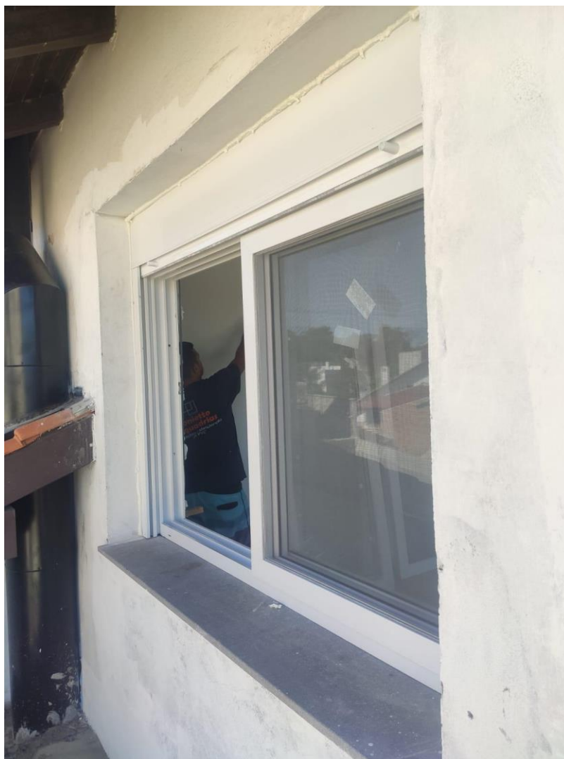
Figura 26 - Interação da janela de PVC com a pingadeira de basalto observada pelo lado externo da edificação
