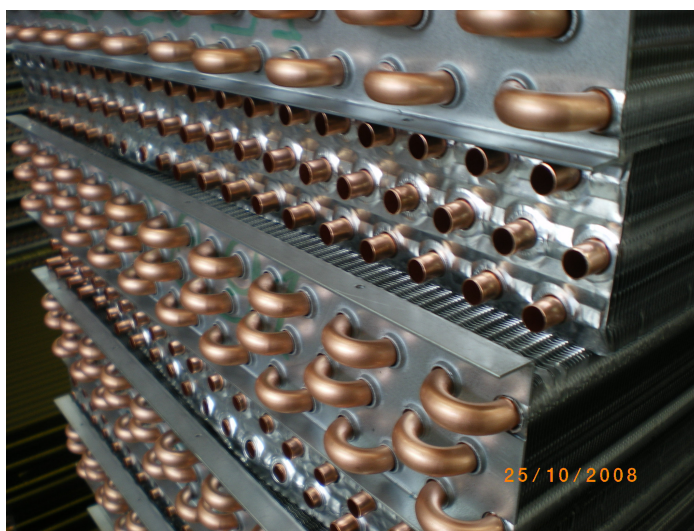
Figura A1.1 – Armazenamento inadequado de serpentinas em etapas anteriores a montagem do aparelho.
