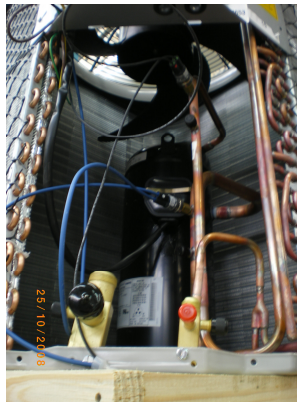
Figura 1.2 – Visão interna da unidade condensadora, detalhes de válvulas
