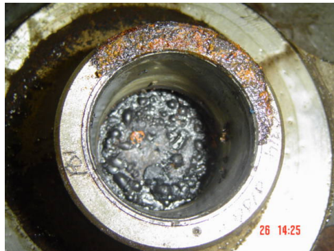
Figura 1.4 – Degradação de óleo do compressor em função de oxidação
