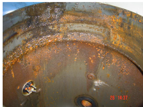
Figura 1.3 – Compressor tipo Scroll avariado por motivo de umidade
