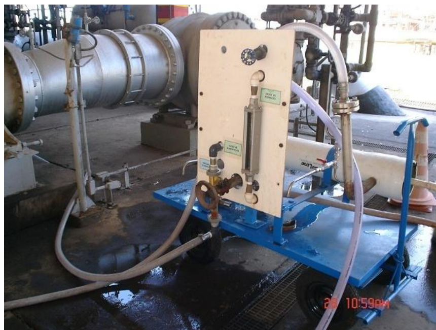
Figura 3.1: Unidade piloto de OI. Fonte: Vitt (2007).
