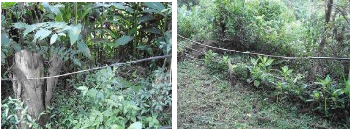
FIGURA 40 - Fios percorrendo 1.200 metros em tubulações expostas no chão ou em canos de PVC.
