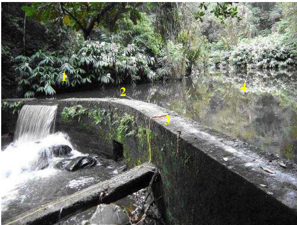
FIGURA 28 - Foto lateral da barragem da Cascata das Borboletas. (1) vertedouro; (2) descarga de fundo; (3) início da tubulação de baixa pressão; (4) área represada.
