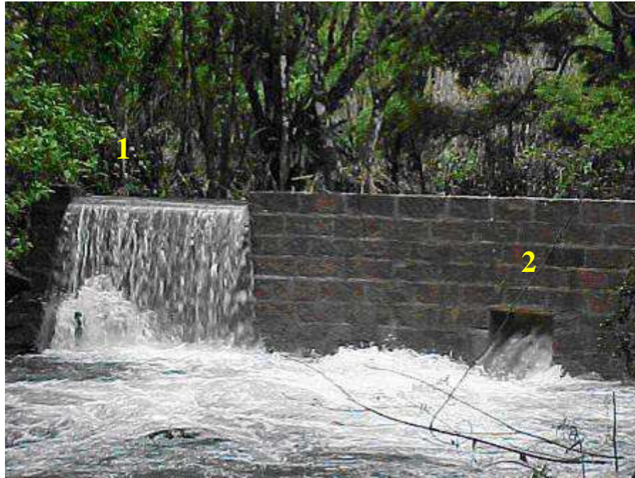
FIGURA 29 - Foto frontal da barragem da Cascata das Borboletas. Detalhe para (1) vertedouro; (2) descarga de fundo.
