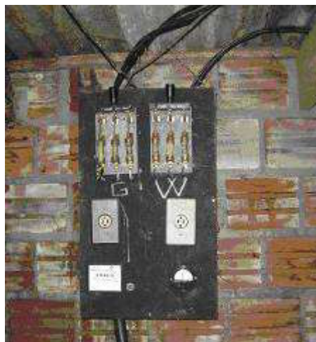
FIGURA 39 - Quadro de Força utilizado na MCH.
