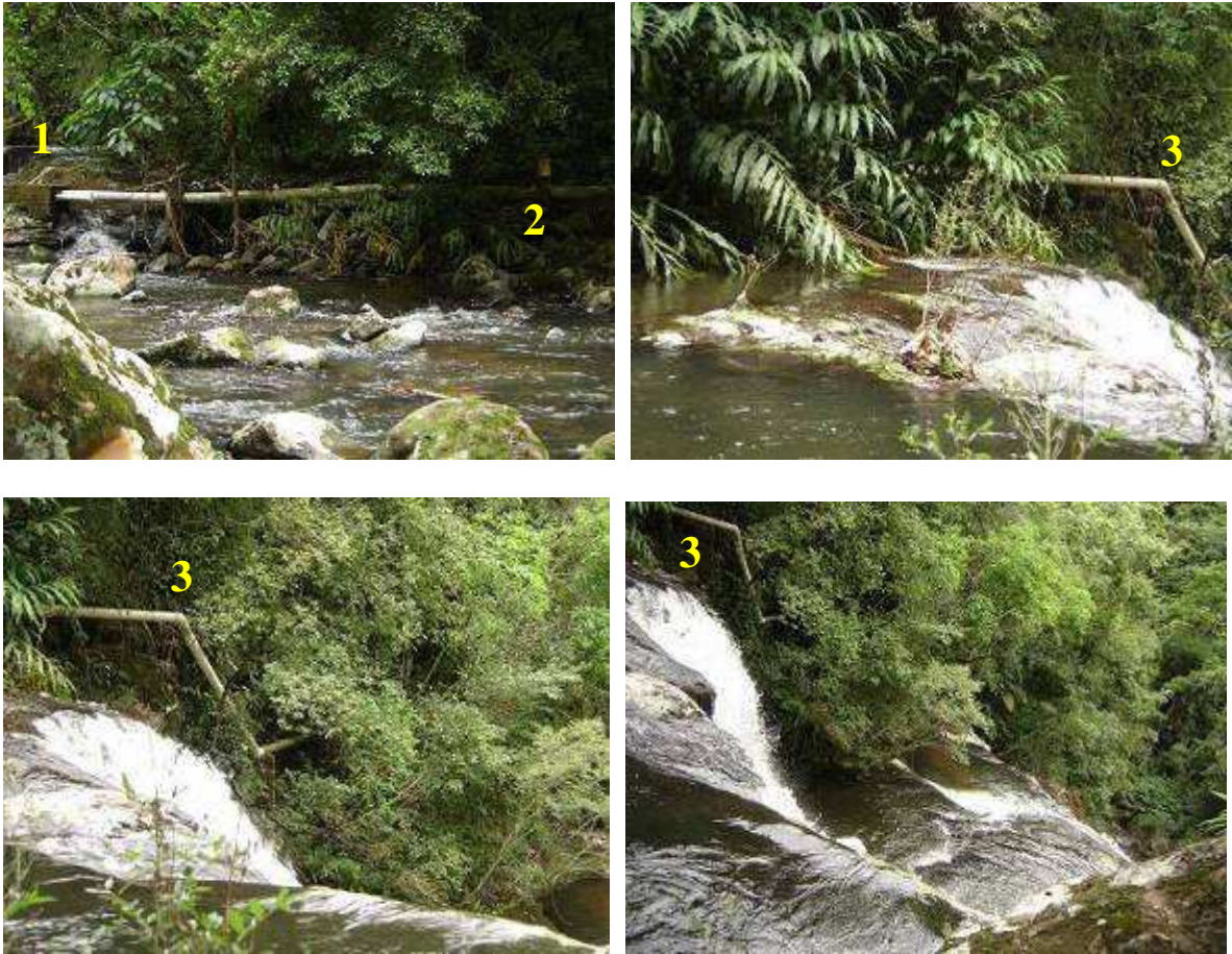
FIGURA 33 - Fotos da tubulação da Cascata das Borboletas. (1) tubulação de adução em baixa pressão; (2) chaminé de equilíbrio; (3) Início da tubulação de alta pressão.
