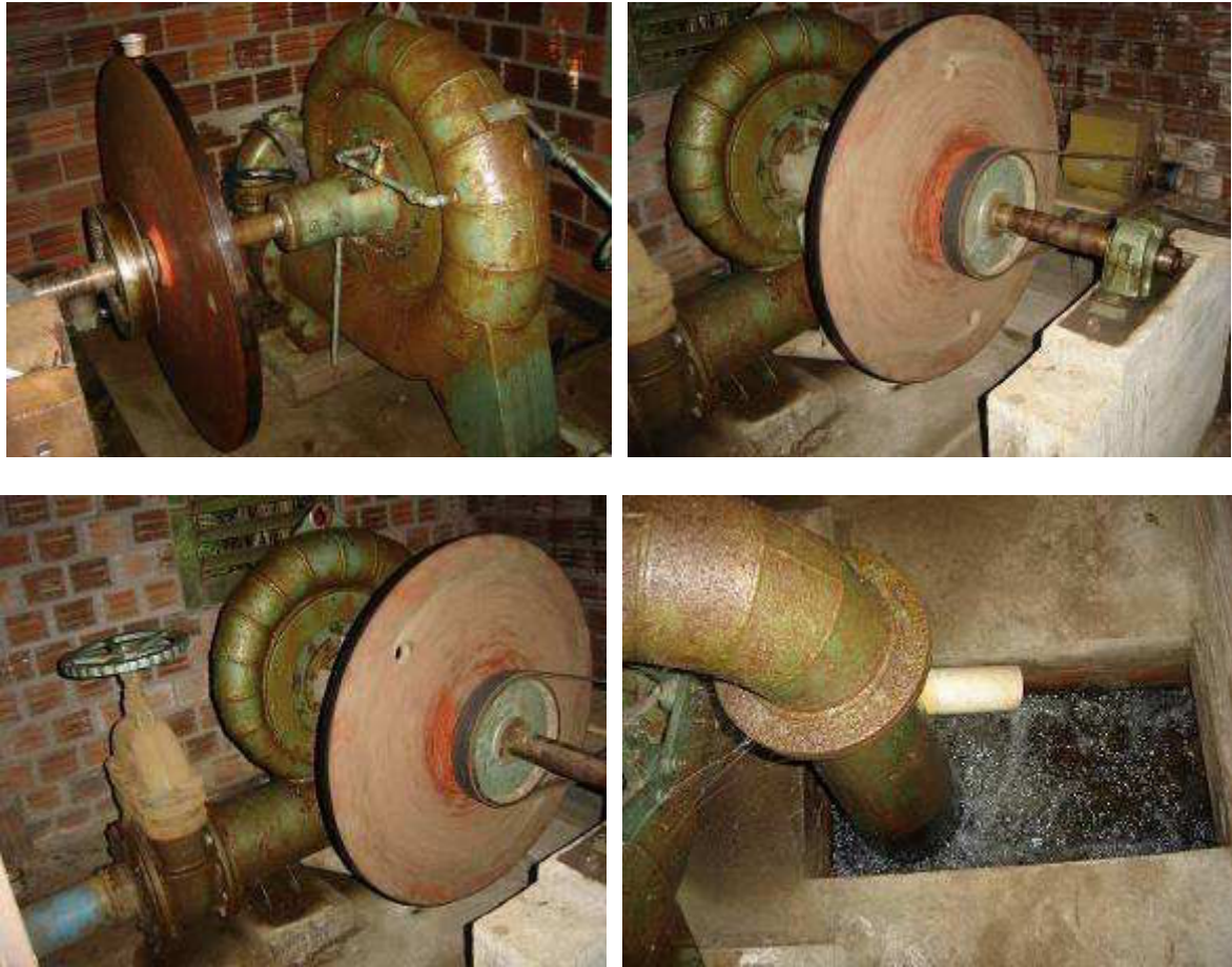
FIGURA 36 - Turbina Francis utilizada atualmente na MCH.
