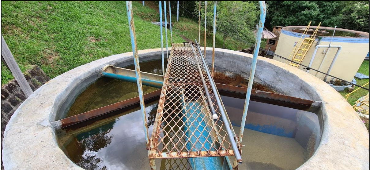
Figura 28 - Filtro Russo (circular) construído em alvenaria (ETA)
