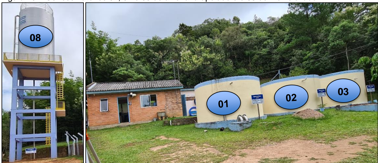
Figura 29 – Os reservatórios 01, 02 e 03 de alvenaria apoiado e o 08 de inox elevado
