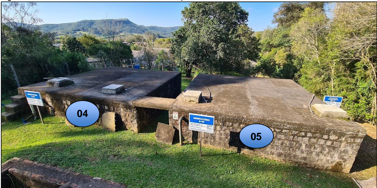
Figura 30 – Reservatórios 04 e 05 de alvenaria apoiado
