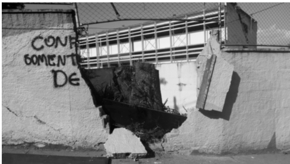
Figura 9 - Muro de escola rompido.
